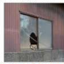
窓が割れた管理不全空家
