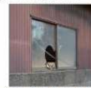
窓が割れた管理不全空家
