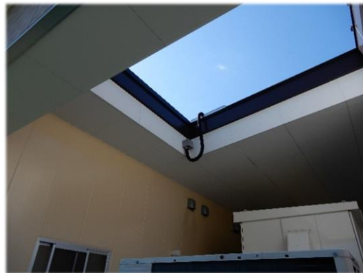
(右) 太陽光パネル設置屋根へのアクセス 設置場所は屋根の上であるが、梯子等は設けられていなかった。
