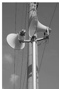
▲田倉地区 (屋外放送設備)
