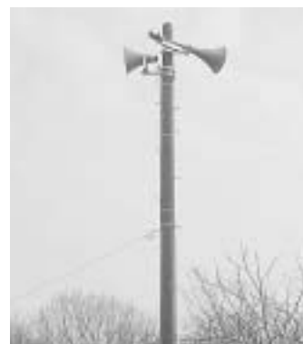
▲屋外放送設備
